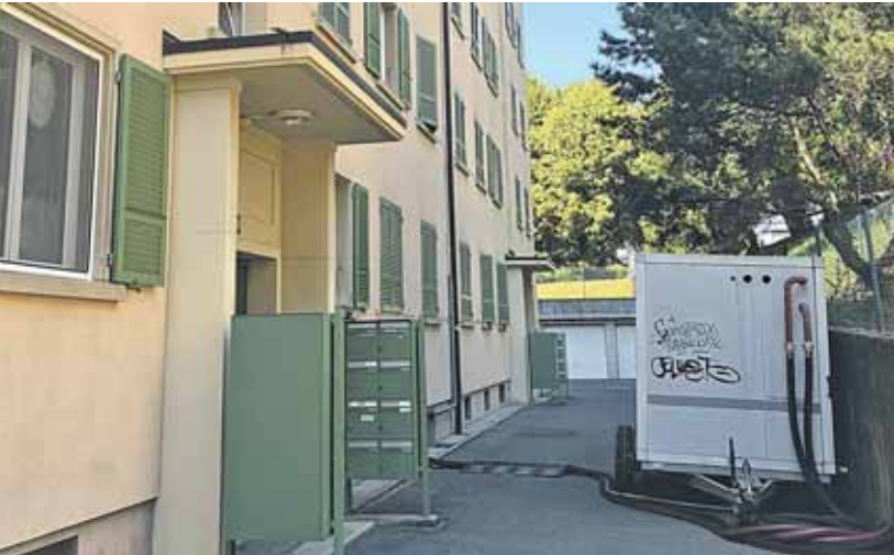
Sous les fenêtres des locataires, la chaudière provisoire suscite des critiques en raison des odeurs et des nuisances ressenties. DR
